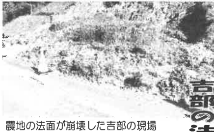
農地の法面が崩壊した吉部の現場
