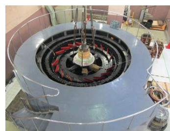
菅野発電所 水車発電機
